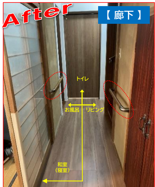
廊下の床が滑りやすく転倒リスクが高かったため、滑りにくいフローリングを貼り、手すりも設置しました。
